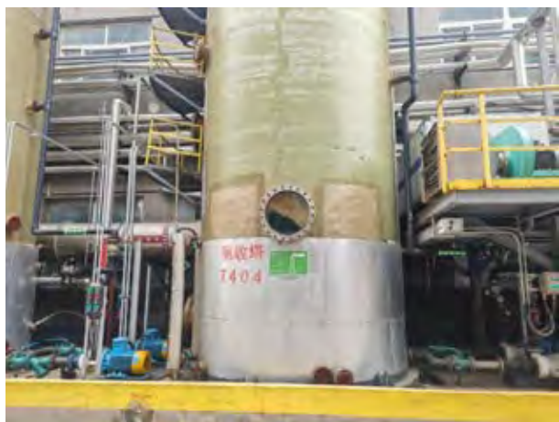
DA010 废气治理设施（湿捕器）
