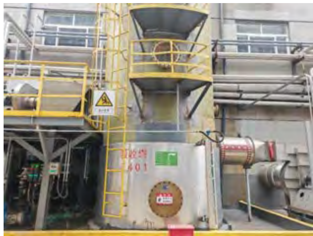
DA030 废气治理设施（湿捕器）
