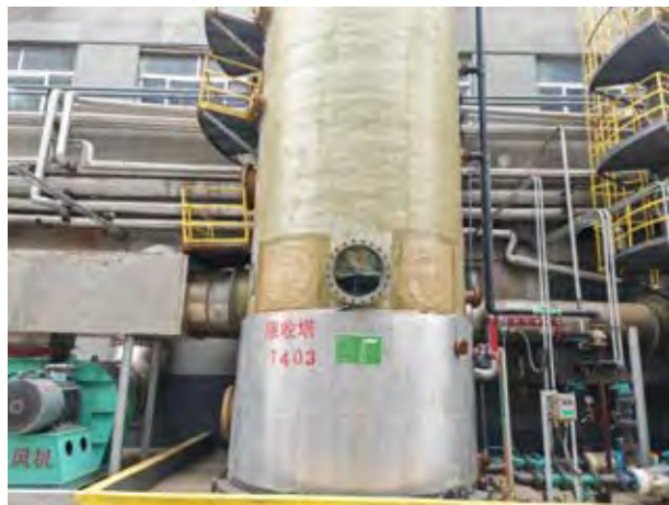
DA009 废气治理设施（湿捕器）
