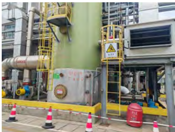
DA008 废气治理设施（湿捕器）
