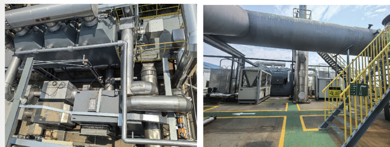
新增“冷凝预处理+G4/F4/F9干式过滤+沸石分子筛吸附+催化燃烧(CO)”组合工艺
