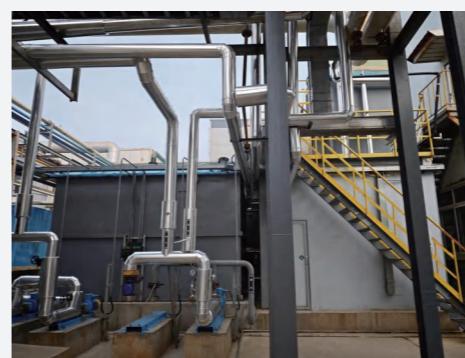
▲ 升级废水预处理设施，减少异味排放
