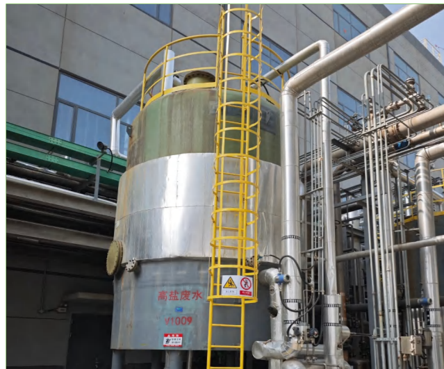
宁夏南厂区在H60氯化车间北侧设备区新增了一座废水罐，并将氟甲化工序的废水和氯化工序的废水进行分离储存处理，降低了安全风险，同时又方便废水指标管控。
