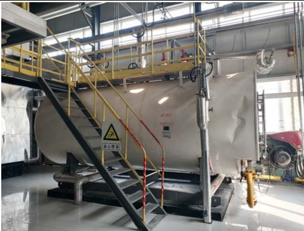
本项目验收锅炉炉体现场照片
